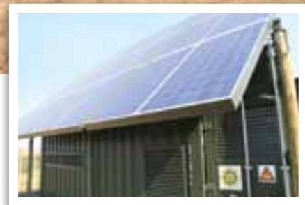
5kw Stand alone PV Array
